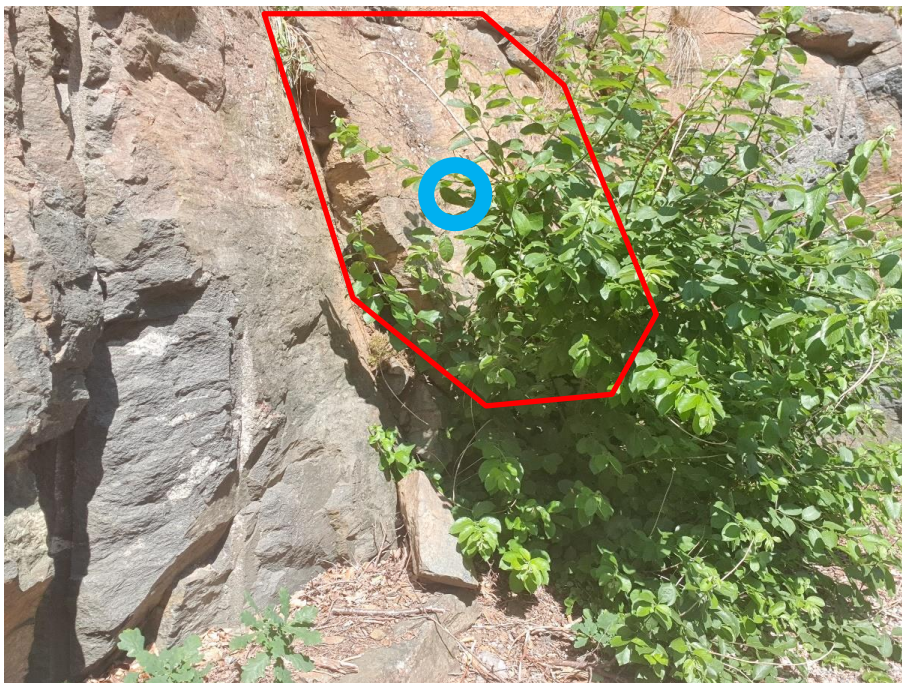
Figur 4.3. Block på medelbrant-brant glidplan bakom busken saknar bottenstöd (rött) samt föreslaget läge för bergbult L=2 m (blått).
