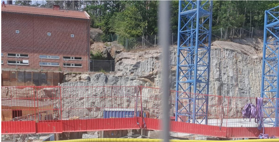
Figur 3.2.3. Den nyligen utsprängda bergskärningen i direkt anslutning till den stora skolbyggnaden. Bild mot väst från Danska vägen.
