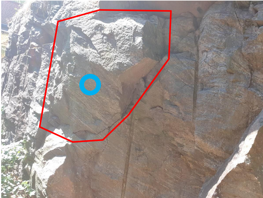
Figur 4.4. Block mitt i skärningen saknar bottenstöd (rött). Om blocket faller ut kan ovanliggande delar av skärningen också destabiliseras. Föreslaget läge för bergbult L=2 m visas med blå ring.
